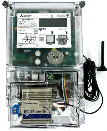
รูปที่ 1-2 Smart meter SMW110 ที่ติดตั้ง Modem TRB142 แล้ว
